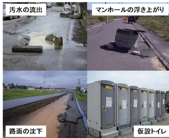
写真 下水道施設被災時の例
