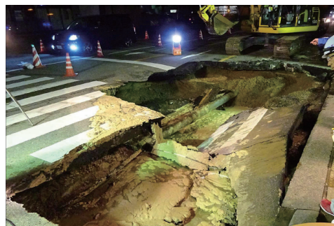
写真 道路陥没事故事例
