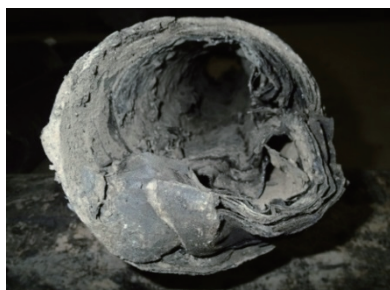
写真-1 硬質瀝青管の水ぶくれ
