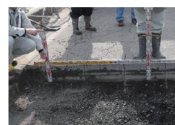
写真-3 層間の滞水状況
