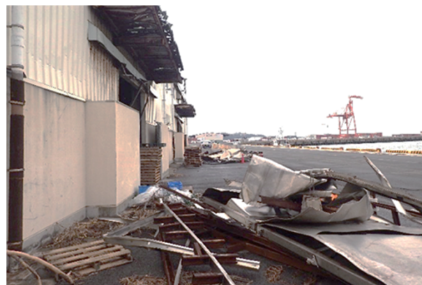
図3 上屋防潮扉の破壊 (和歌山下津港)
