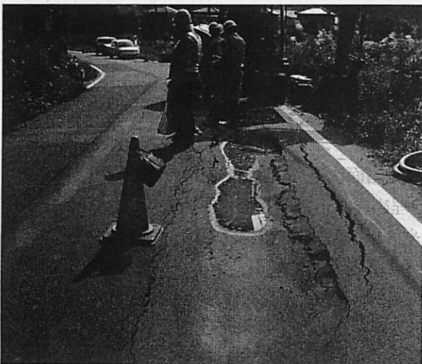
写真-1 被災箇所の路面沈下
